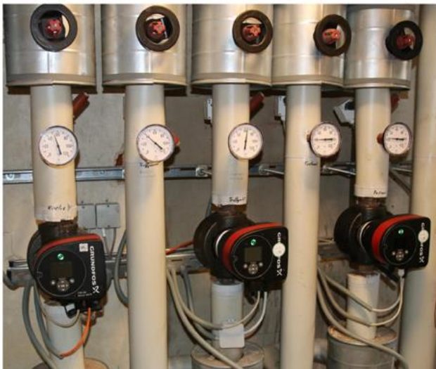
Die neuen energieeffizienten Pumpen in der LWL-Klinik Lengerich
