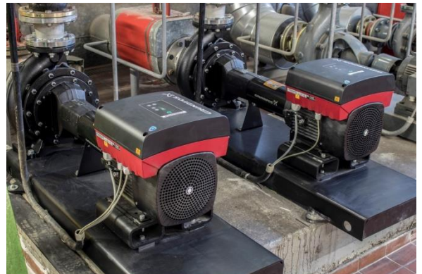
Hocheffiziente Pumpen leisten nicht nur einen effektiven Beitrag zum Klimaschutz, sondern senken nachweislich die Betriebskosten Quelle: pesContracting GmbH
