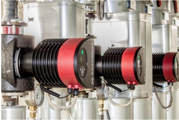
Moderne Heizungsumwälzpumpen verbessern die Energieeffizienz und sorgen für eine höhere Betriebssicherheit im Klinikum Landshut. Quelle: pesContracting GmbH
