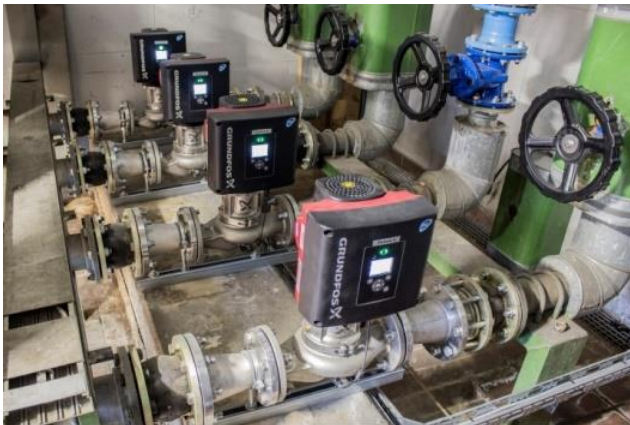
Hocheffizient und zuverlässig: Moderne Warmwasserzirkulationspumpen des Typs TPE3 von Grundfos optimieren die Versorgungssysteme im DONAUISAR Klinikum Deggendorf. Quelle: pesContracting GmbH
