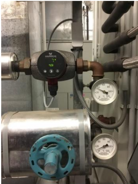
Klein, energieeffizient, langlebig: Moderne Heizungsumwälzpumpen der Baureihe ALPHA2 von Grundfos verbessern die Versorgungssysteme im DRK Krankenhaus Altenkirchen-Hachenburg. Quelle: pesContracting GmbH
