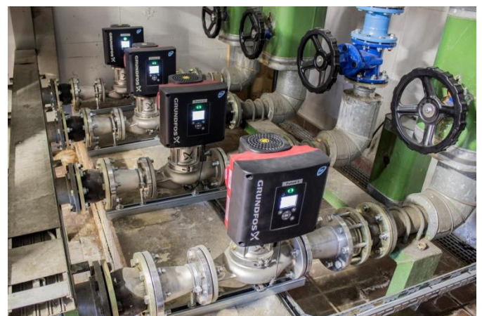
Hocheffizient und zuverlässig: Moderne Warmwasserzirkulationspumpen des Typs TPE3 von Grundfos Quelle: pesContracting GmbH
