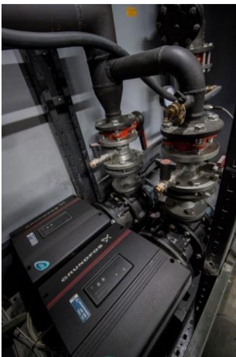
Grundlage des PumpenEnergieSpar-Concepts bildet die moderne Technologie von Grundfos. Quelle: pesContracting GmbH
