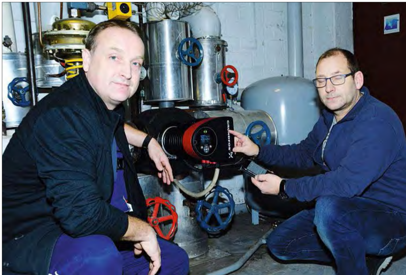
Die neuen Pumpen im Gezeitenland (oberes Foto) sparen CO2 und Kosten.
