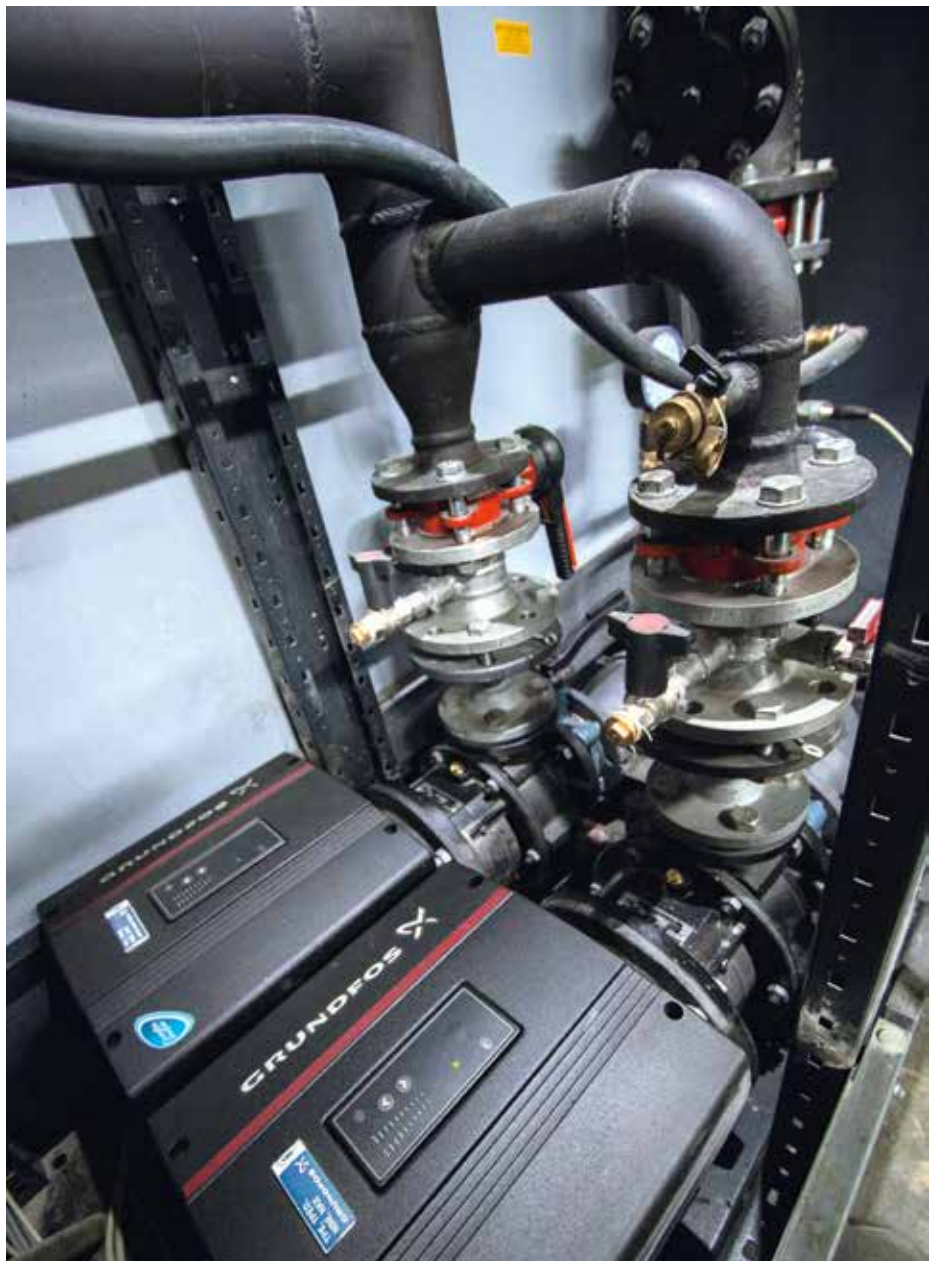
Grundlage des Energiespar-Konzepts bildet die moderne Technologie von Grundfos.
