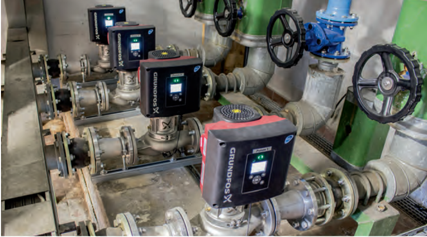
Als Komplettdienstleister übernimmt die pesContracting GmbH sowohl die Bestandsaufnahme eines Pumpentauschs als auch die Auslegung und den Umbau. Bild: pesContracting
