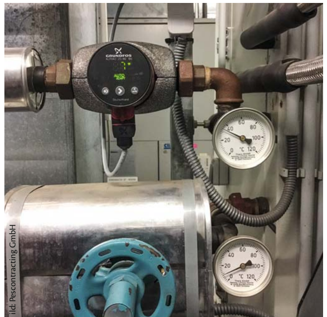
Effiziente Pumpentechniken in Bestandsanlagen können Strom und Kosten einsparen
